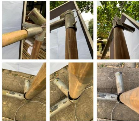
Gambar 7 Deformasi Kedua Sambungan Sumber: Dokumentasi Penulis 2022
