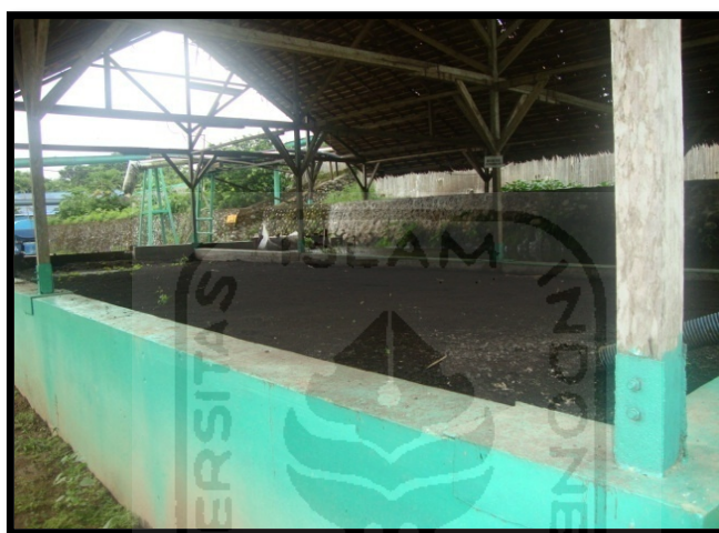
Gambar 3.2 Sludge Drying Bed Pada Instalasi Pengolahan Air Limbah (IPAL) Karet PT.DKJ (Sumber : Data primer, 2011)
