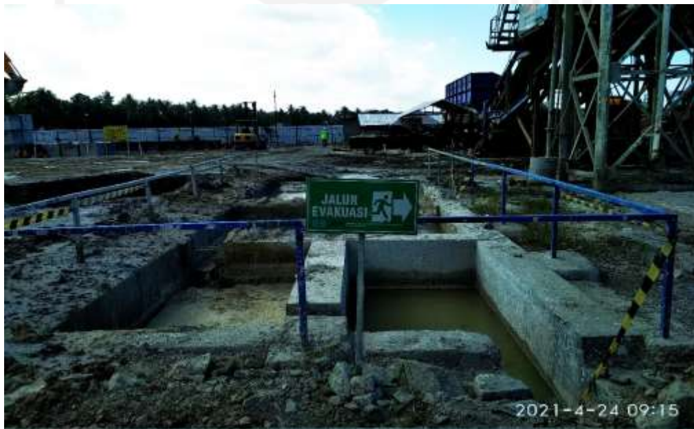
Gambar 5. 28 Bak Kelola Limbah Beton Cair (Sumber: Dokumen Pribadi, 24 April 2021)
