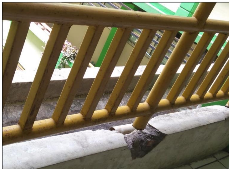
Gambar 5.3 Kerusakan Beton pada Pagar Pengaman
