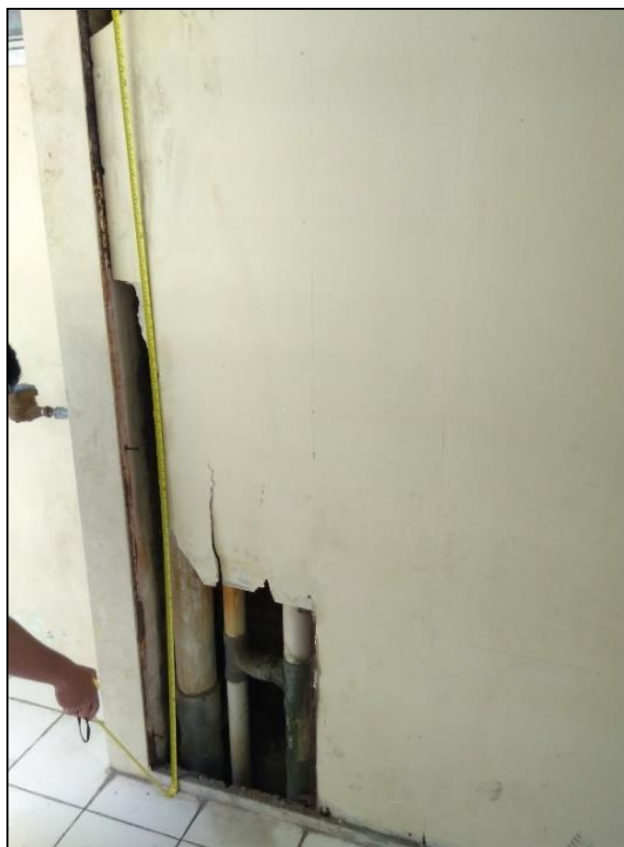
Gambar 5.5 Kerusakan pada dinding kayu lapis penutup saluran pipa
