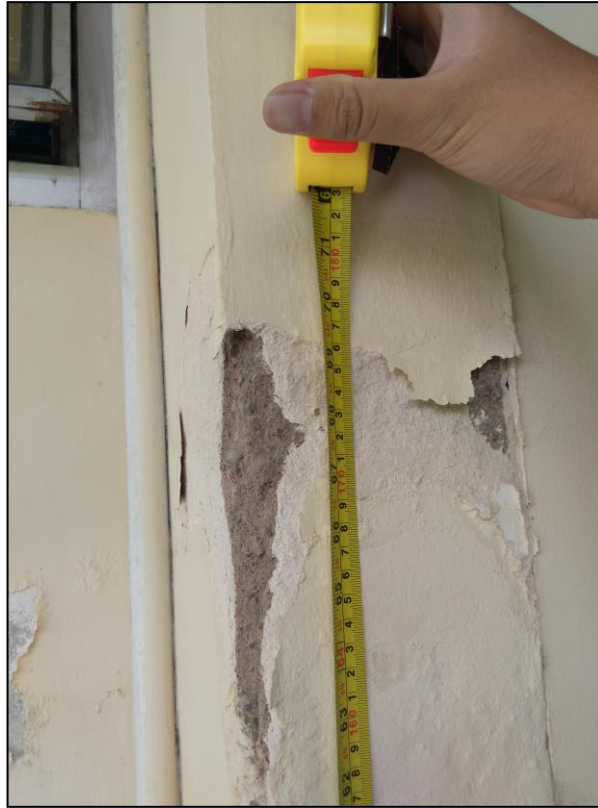
Gambar 5.8 Kolom yang Terkelupas
