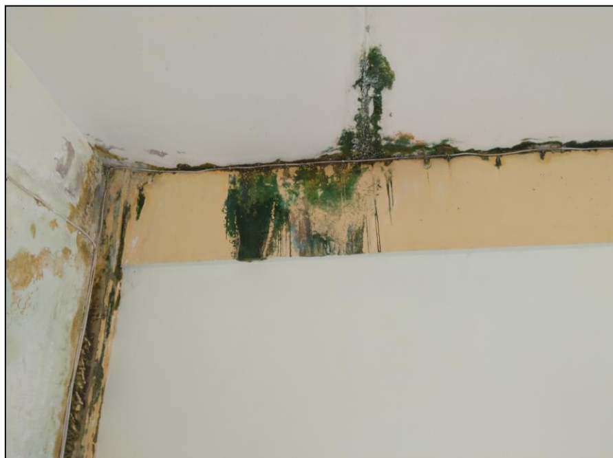
Gambar 5.6 Plat Lantai yang Mengalami Rembes
